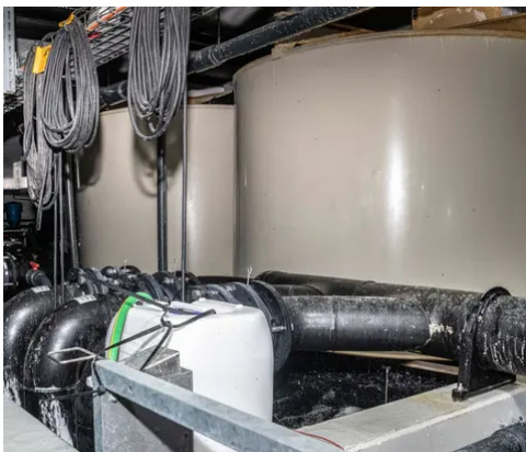
Insgesamt 300'000 Liter Wasser müssen die Filter rund um die Uhr reinigen.
